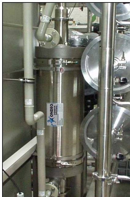
脱气膜在 8m 3 /h ROCEDIS 工厂的使用
